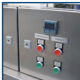
Prozesswasser-temperaturregelung über Einzelregler
