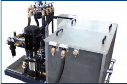
Prozesswassersystem mit Filtrierung und Temperierung
